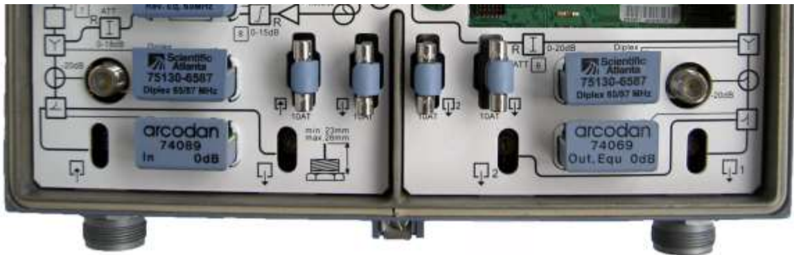
Abbildung 7 : Sicherungshalter für Fernspeisung
